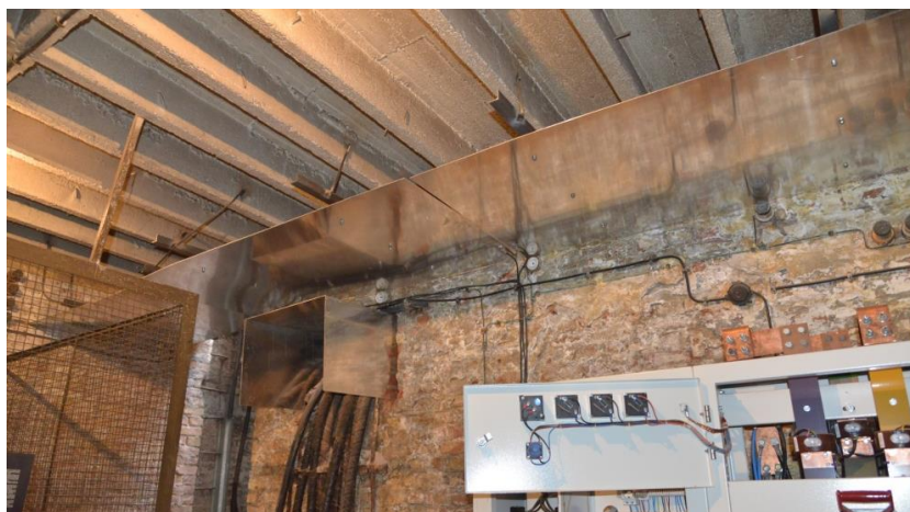
СЛИКА 8 – Заштитни екрани накнадно постављени у угао просторије трансформаторске станице
