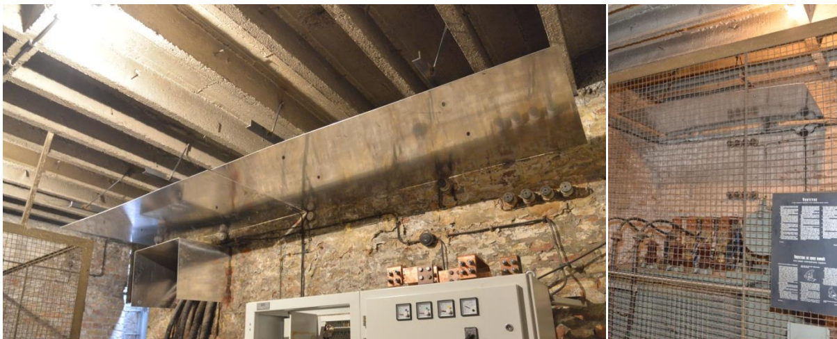
СЛИКА 7 – Заштитни екрани првобитно постављени у трансформаторској станици
